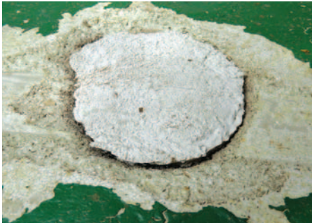
Ein Deckel der wohl mit Gips repariert wurde. Der Farbanstrich hält auf Gips nicht und zwischen Styropor und Gips sind starke Verwitterungsspuren zu sehen.
