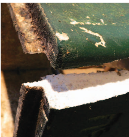
Eine geplatze Zarge. Wahrscheinlich auf eine Kante gefallen.
