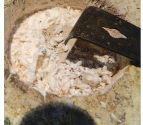
Nach dem Herauslösen der schadhafte Stelle.
